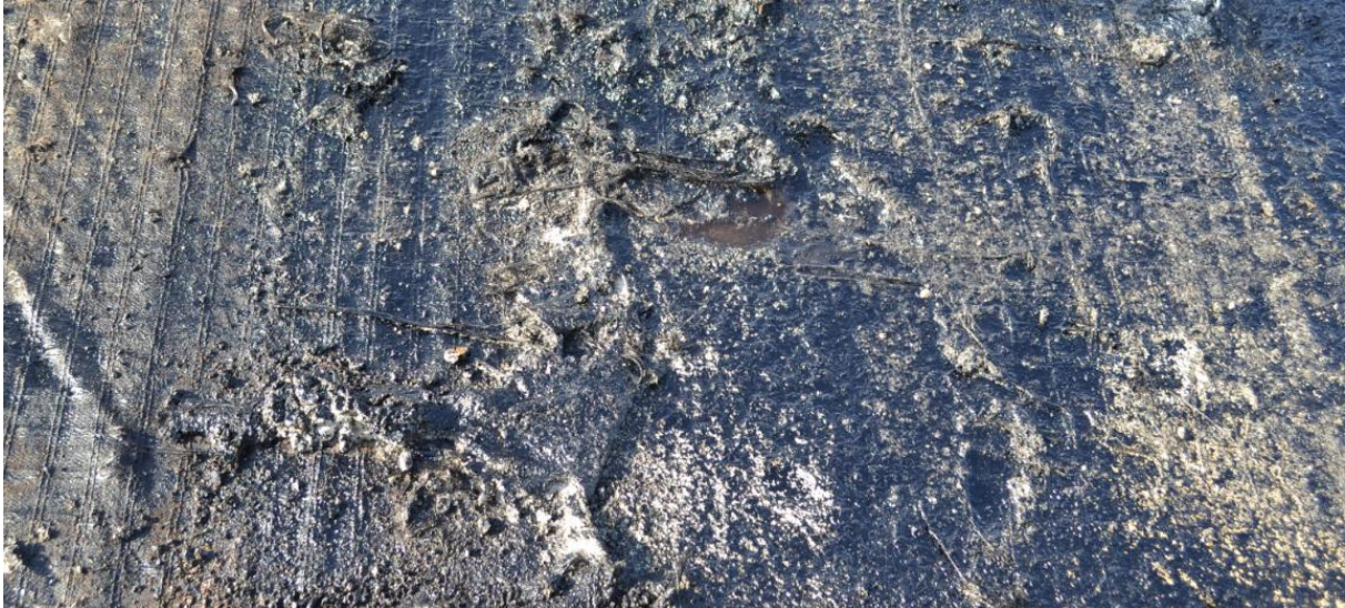
Slika 14. Prikaz oštećenja staklene mreže prilikom vožnje mehanizacije
